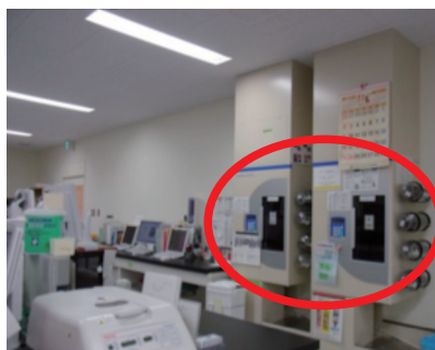
検体搬送用エアシューター
